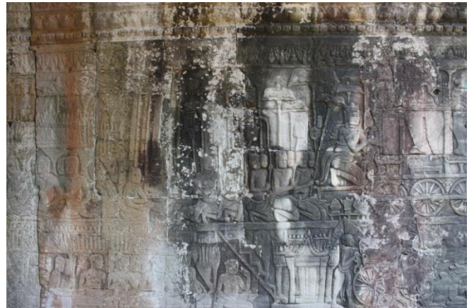
図4 バイヨン寺院内回廊壁面の浮き彫りに発生したバイオフィーム
